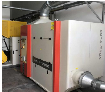
破碎粉尘治理设施
